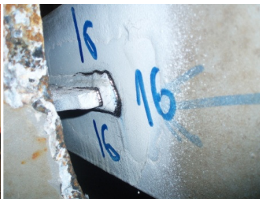
Fig 15 Shiny weld groove
